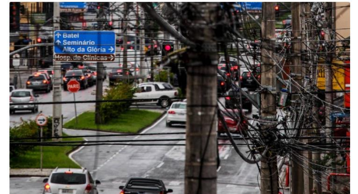
Postes de Curitiba estão tomados por fios, muitos deles inúteis, de operadoras. Foto: Arquivo/Daniel Castellano
